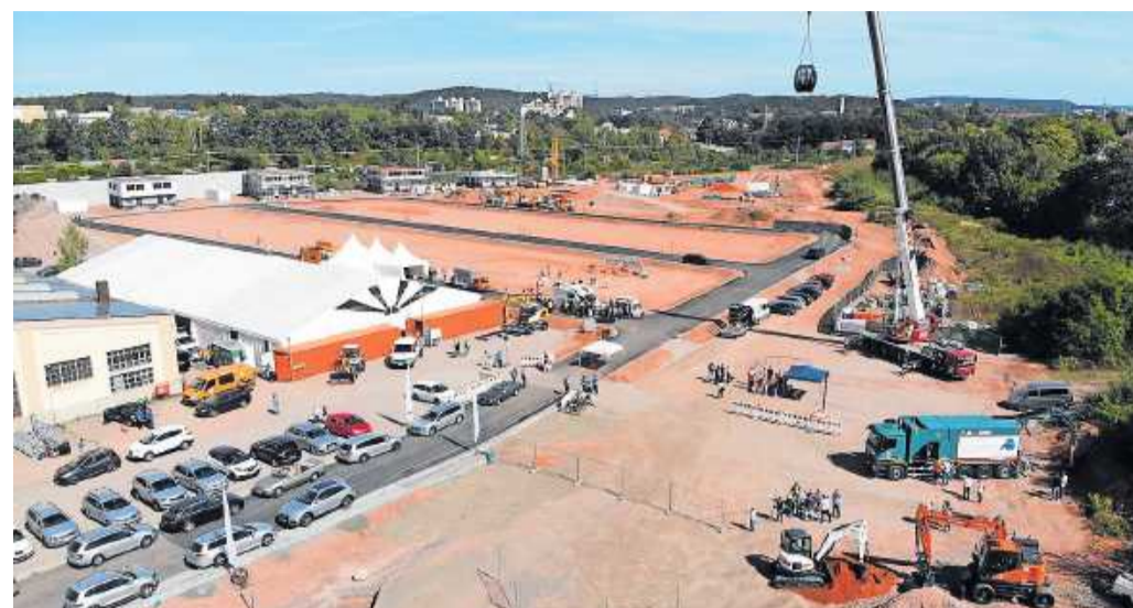
Das Baugelände „Pariser Straße 300“ liegt in direkter Nachbarschaft zur historischen Gartenstadt Bahnheim und wurde für die Landesgartenschau und die Fußballweltmeisterschaft als Park-and-ride-Parkplatz genutzt
