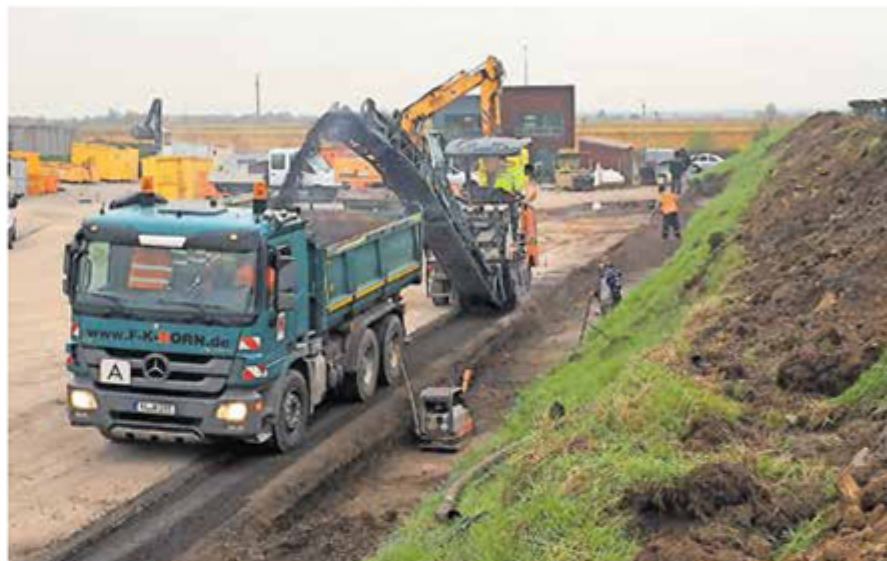
Stand der Bauarbeiten Anfang November: Abfräsen der alten Asphalttschicht und ausgehobener Graben für die Frostschutzschicht der neuen Stablwände.
